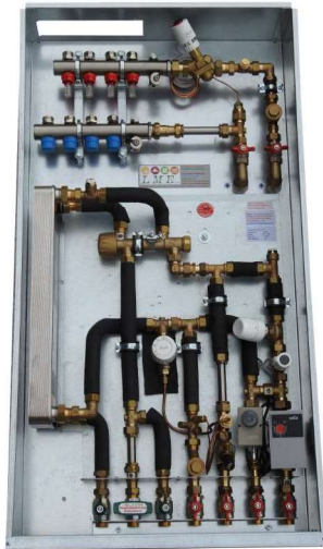
Wohnungsstation mit PM - Regler für Warmwasser und Fußbodenheizung + direkte Deckenkühlung in UP1200x610x150mm
