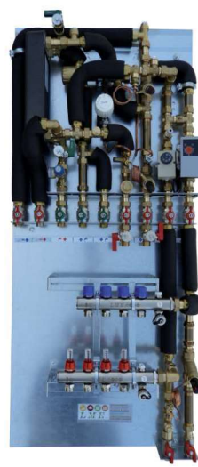
Wohnungsstation für WW, Fußbodenheizung mit Einspritzschaltung & Regelung über GLT (2 Motorventile), Fußbodenkühlung über GLT (2 Motorventile) in Aufputzausführung
