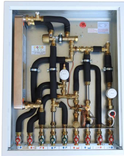
Wärmepumpen - Wohnungsstation für Warmwasser- und Radiatorenheizung mit PM - Regler, Zonenventil + Stellmotor, Hochtemperaturabgang auf Montageschablone gezogen Rücklauftemperaturbegrenzer in UP810x610x150mm
