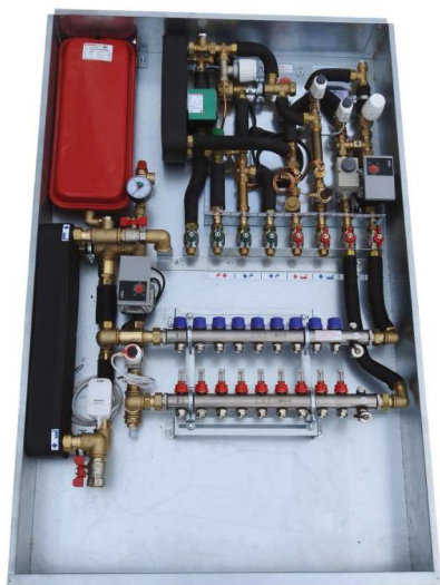
Wohnungsstation für WW mit Zirkulation FB-Heizung m. Festwertregelung + FB-Verteiler Fußbodenkühlung mit Systemtrennung + Steuerung über GLT
